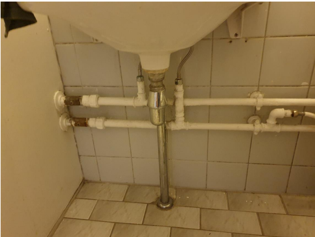
Installationer til håndvask. Eneste type bolig, hvor afløbet fra håndvasken ikke er ført direkte ned i gulv afløbet, men i stedet ført i gulvet til gulv afløbet.
