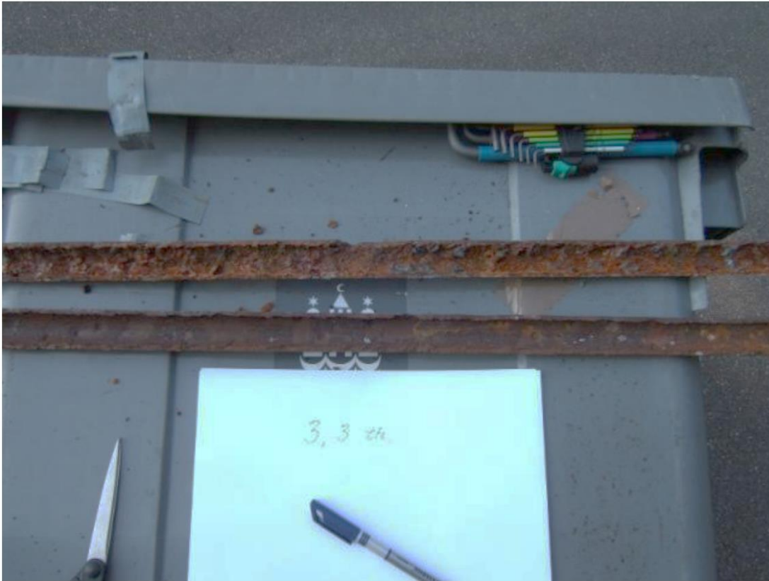
Rørprøve udtaget på stigstreng for varmt vand cirkulation i nr. 3, 3. th. med 80 % afsætning og 80 % tæring.
