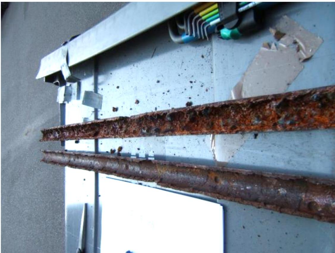
Rørprøve udtaget på stigstreng for varmt vand cirkulation i nr. 3, 3. th. med 80 % afsætning og 80 % tæring.
