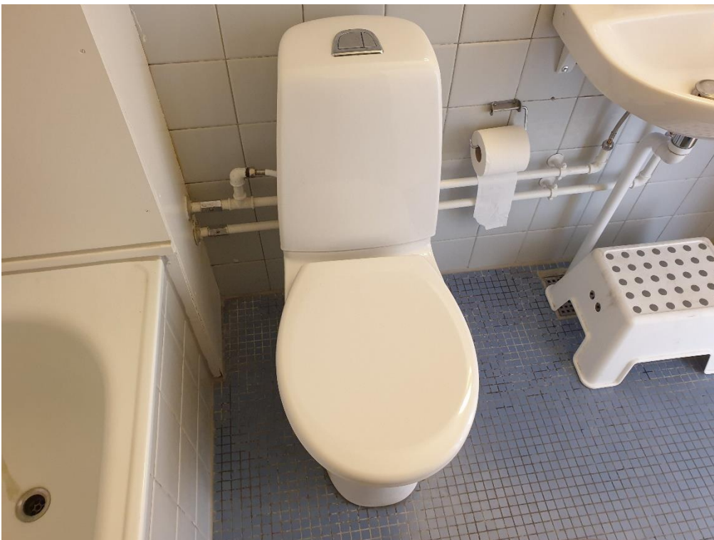
Der er ført installationer ud gennem kassens sider. Synlige koblingsledninger på væggen.
