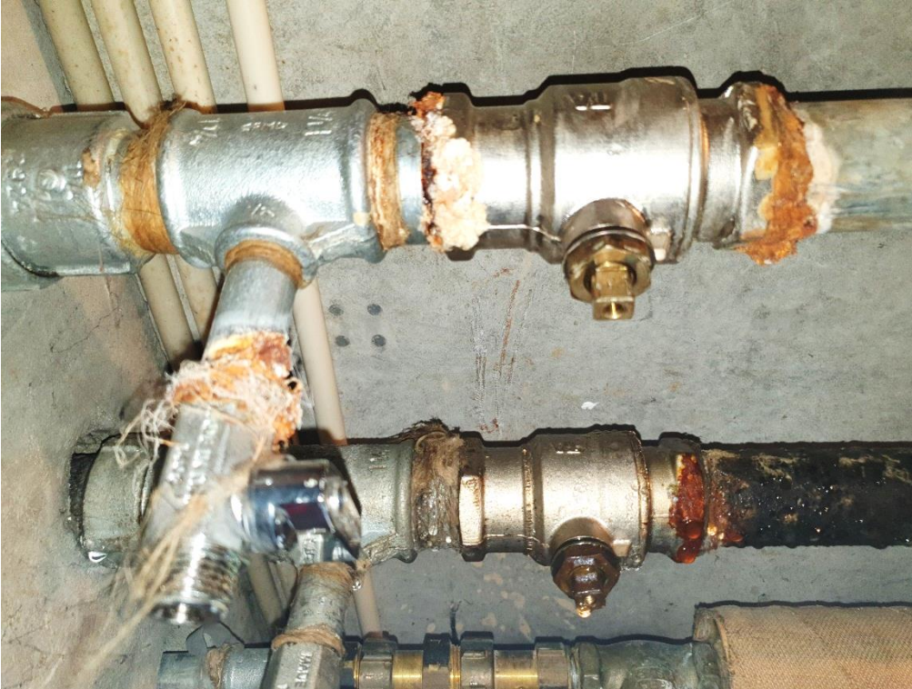
Korrosion i samlinger mellem brugsvandsrør af galvaniseret stål og ventiler af messing i kælder.
