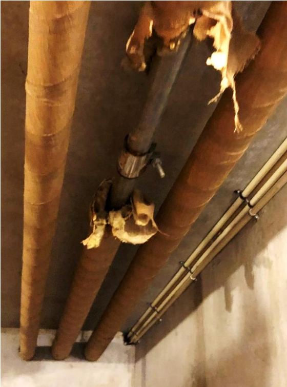
Bandagemuffer på brugsvandsrør i kælder.
