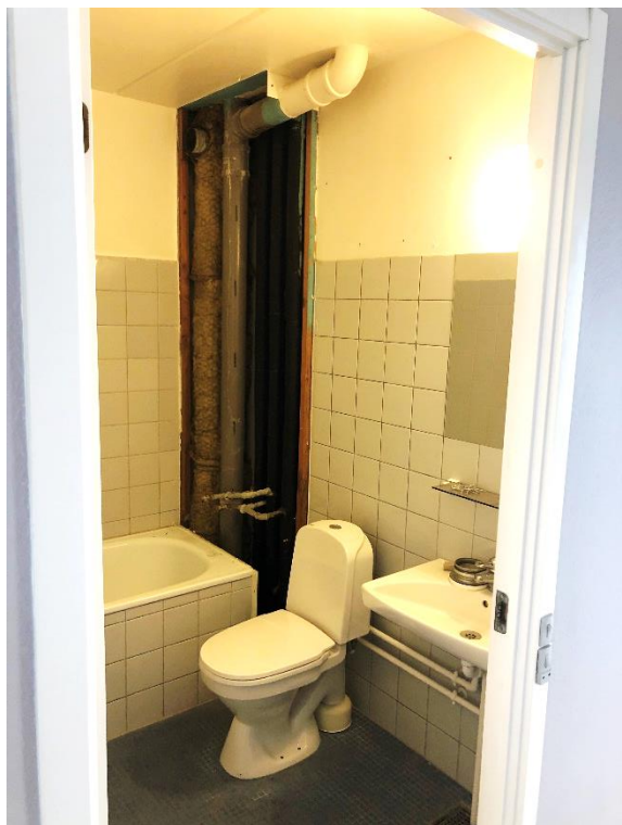
I en af de besigtigede boliger blev hele installationskassen demonteret.
