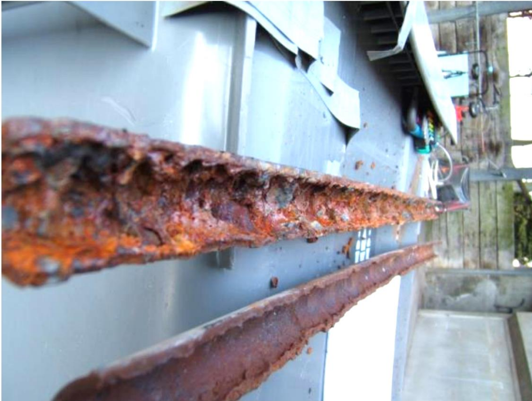
Rørprøve udtaget på stigsstreng for varmt vand cirkulation i nr. 3, 3. th. med 80 % afsætning og 80 % tæring.
