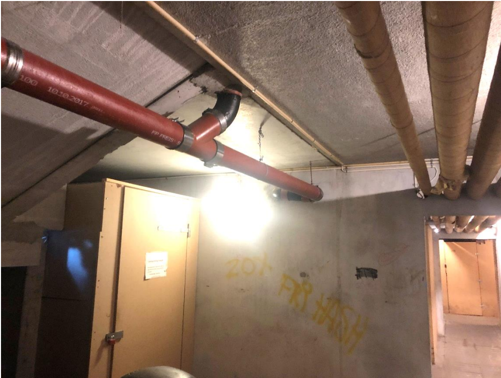
Partiel udskiftning af afløbsrør i kælder, hvilket kunne ses flere steder.
