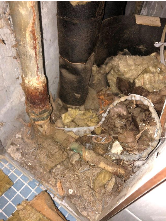
Korrosion på brugsvandsstigsstreng i bolig.
