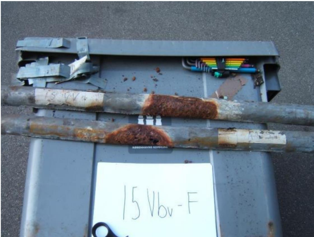
Rørprøve udtaget på kælderledning for varmt vand i nr. 15 med 30 % afsætning og 90-100 % tæring.
