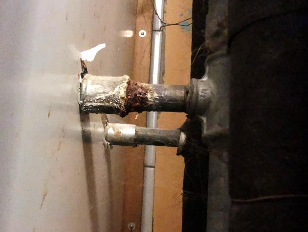
Korrosion på afgrening til brusebatteri i bolig, Bodenholfs Plads nr. 1, 1. sal.
