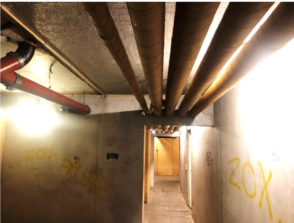
Installationer ført i kælderen, synligt under loftet.
