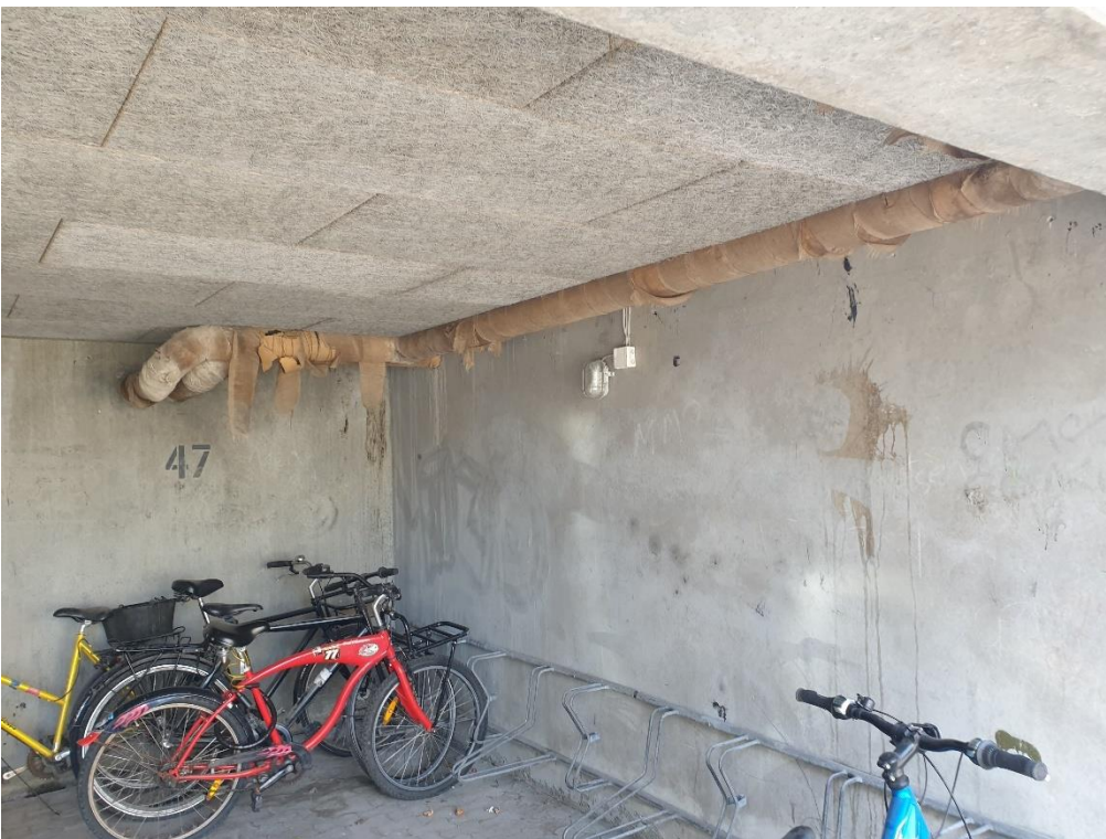
Installationer ført i det overdækkede P-område udenfor.
