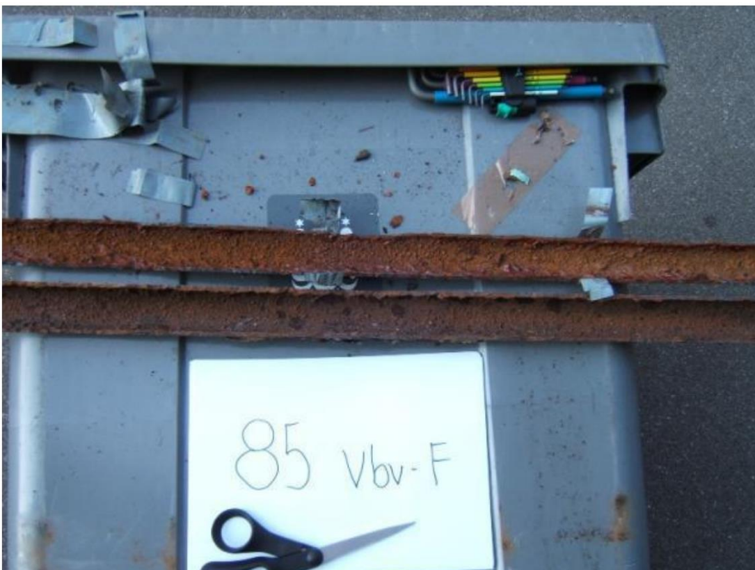
Rørprøve udtaget på kælderledning for varmt vand i nr. 85 med kun 5-8 % afsætning og <5 % tæring.
