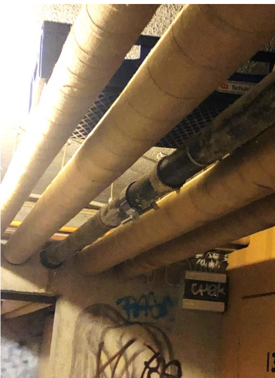
Bandagemuffer på brugsvandsrør i kælder.
