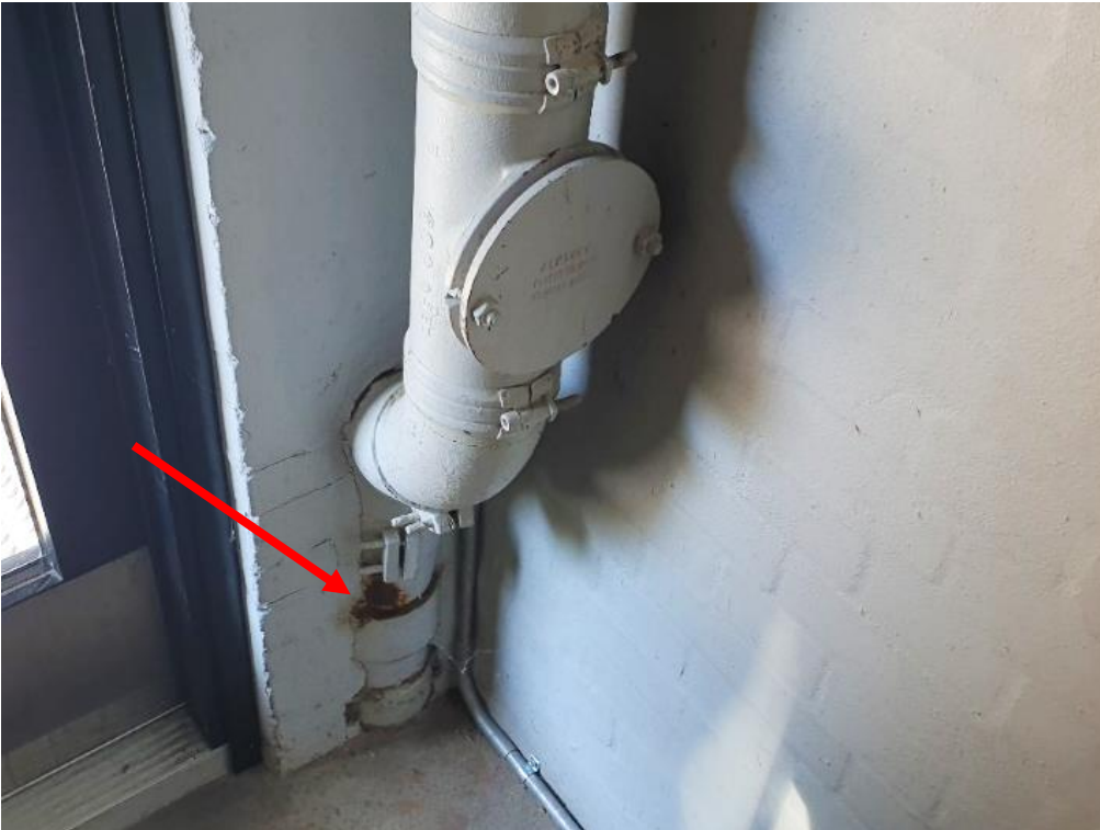
Tæring på faldstamme i opgang, Bodenholfs Plads nr. 5.
