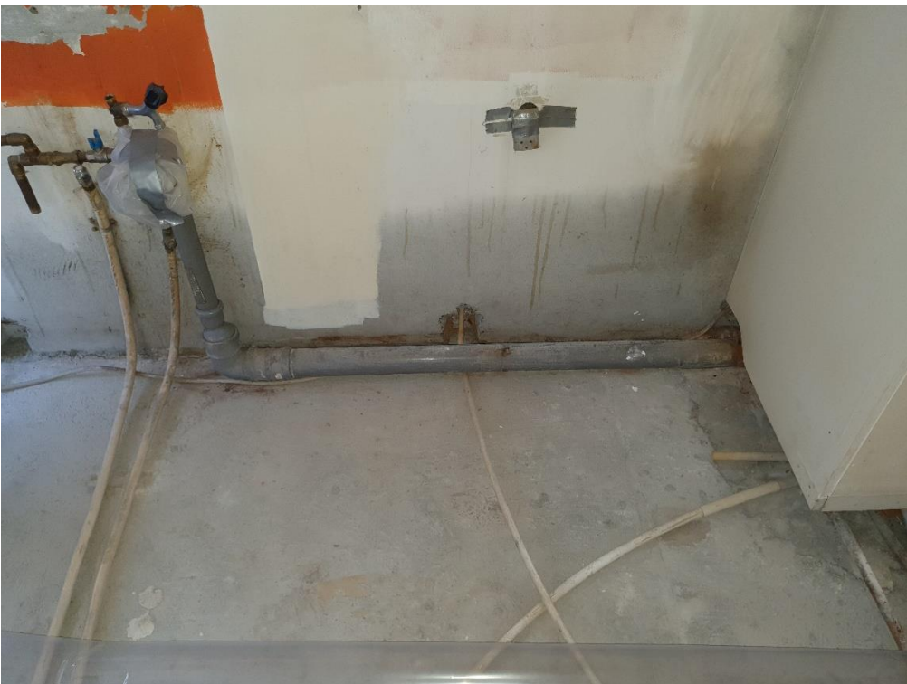
Foto fra køkkenet, hvor kobberørene er ført op til forsyning af køkkenvasken. Afløbsrøret, der betjener køkkenvasken er ført helt nede ved betondækket, og er normalt dækket af trægulv og køkkenindretning.
