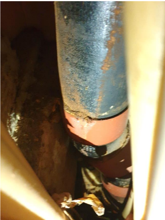
Tæring på faldstamme i bolig, Bodenholfs Plads nr. 5, 1. sal
