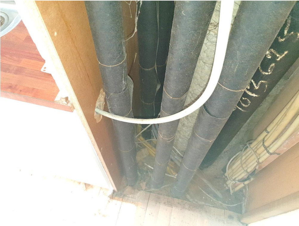
Afgreninger på vandrørene til både køkken og badeværelse er udført skjult under gulvet.
