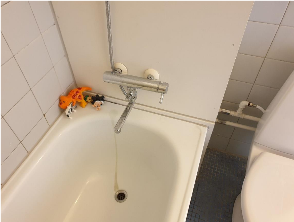
Der er ført installationer ud gennem kassens sider. Kassen er derfor ikke direkte demonterbar.
