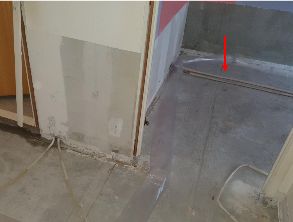
Foto fra bolig, hvor der blev konstateret lækage på et kobberør under gulv. Alle gulve i boligen var taget op og affugtning sat i gang. Rørene er ført fra badeværelset, gennem værelset og til køkkenet.
