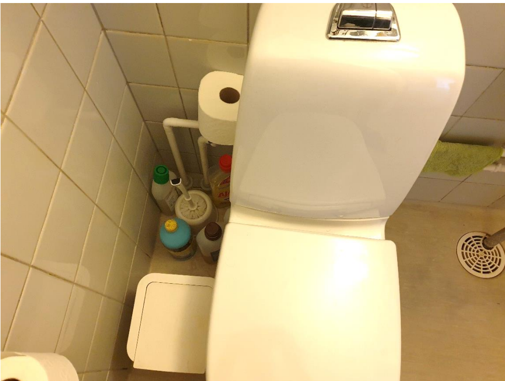
Vandrørene er ført under gulvet fra køkkenet og er ført op ved siden af toilettet i badeværelset.
