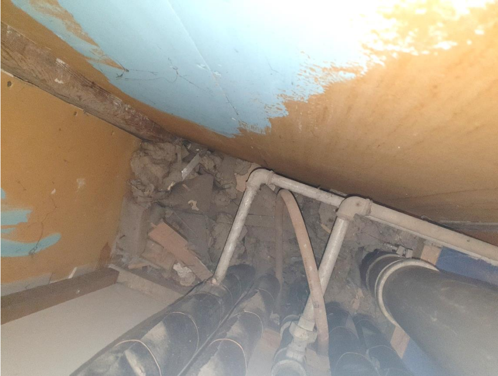
Kig ind i skakten i badeværelset. Fotoet er taget i en bolig på 1. sal i blok P, og udsugningskanalen er derfor kun ført ned til umiddelbart under loft i denne bolig.
