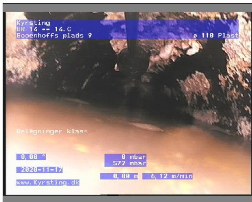
Foto: BR 14-14.CBoenhoffs plads 92-SI_Spare5_A.JPG, Medie #: 24-08-2020, 00:00:24 0m, Belægninger klasse 3, fra urref 00 til urref 12, Kloakhud, På rørvæg, Start
