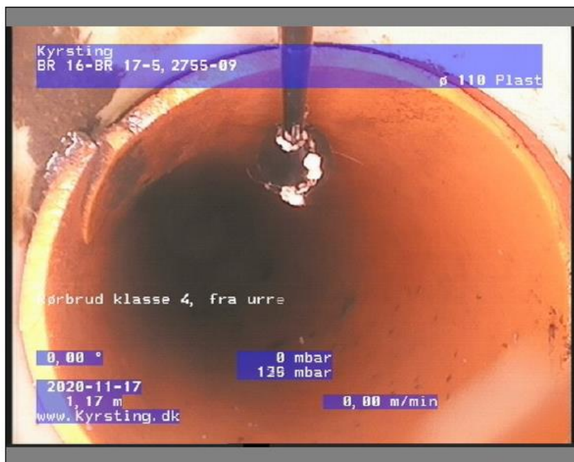
Foto: 50_5A, Medie #: 24-08-2020, 00:01:41 1,17m, Rørbrud klasse 4, fra urref 6 til urref 10, Sammensatte revner
